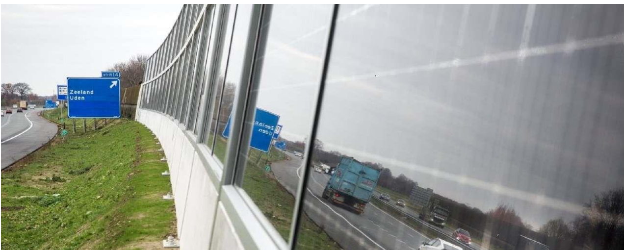
Geluidsscherm met dubbelzijdige zonnepanelen Foto: Rijkswaterstaat
